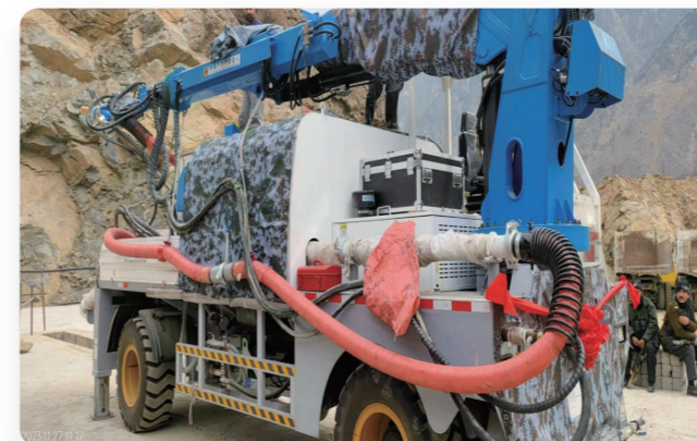
巴基斯坦DASU KKH-02左岸改线公路项目 Pakistan DASU KKH-02 Left Bank Diversion Highway Project
